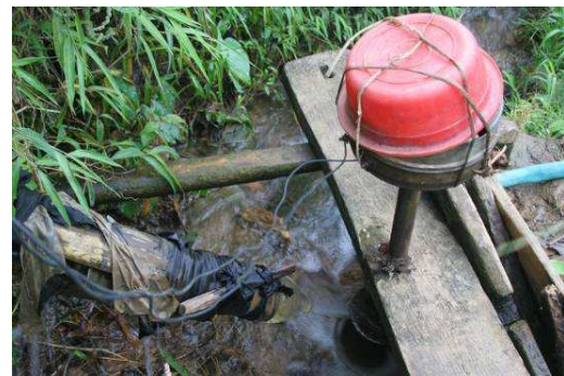
Une des turbines autour du village
